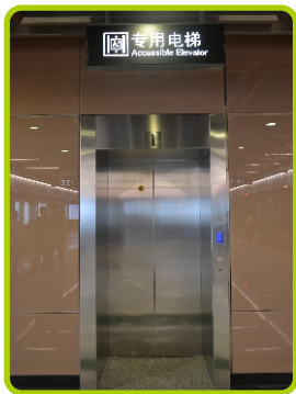
专用电梯 Accessible Elevator
